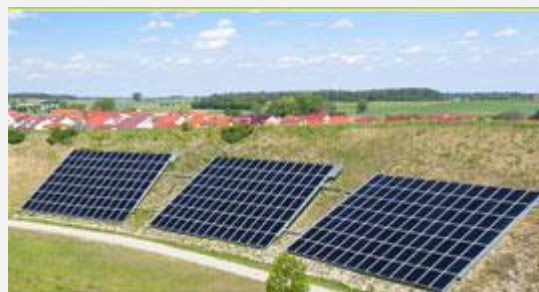
Abb. 73 – Beispiel Solarwall in Crailsheim
